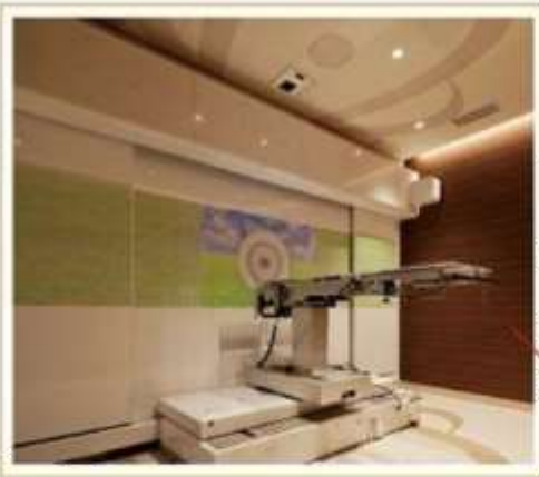
Sala di trattamento
